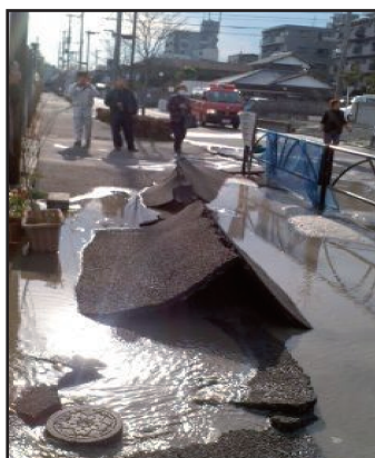
液状化による噴砂発生状況
