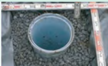
■宅地への雨水浸透ますの設置
