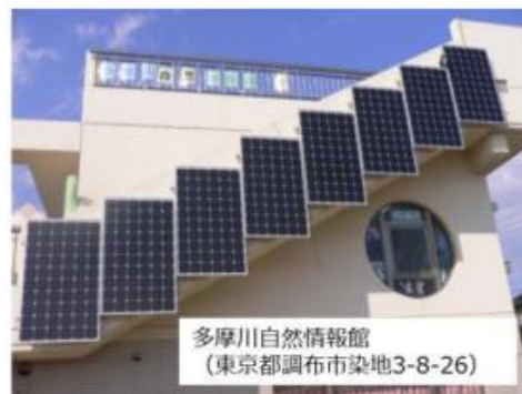
※多摩川に面していることから、建物の屋上以外に外壁にも太陽光パネルを設置
