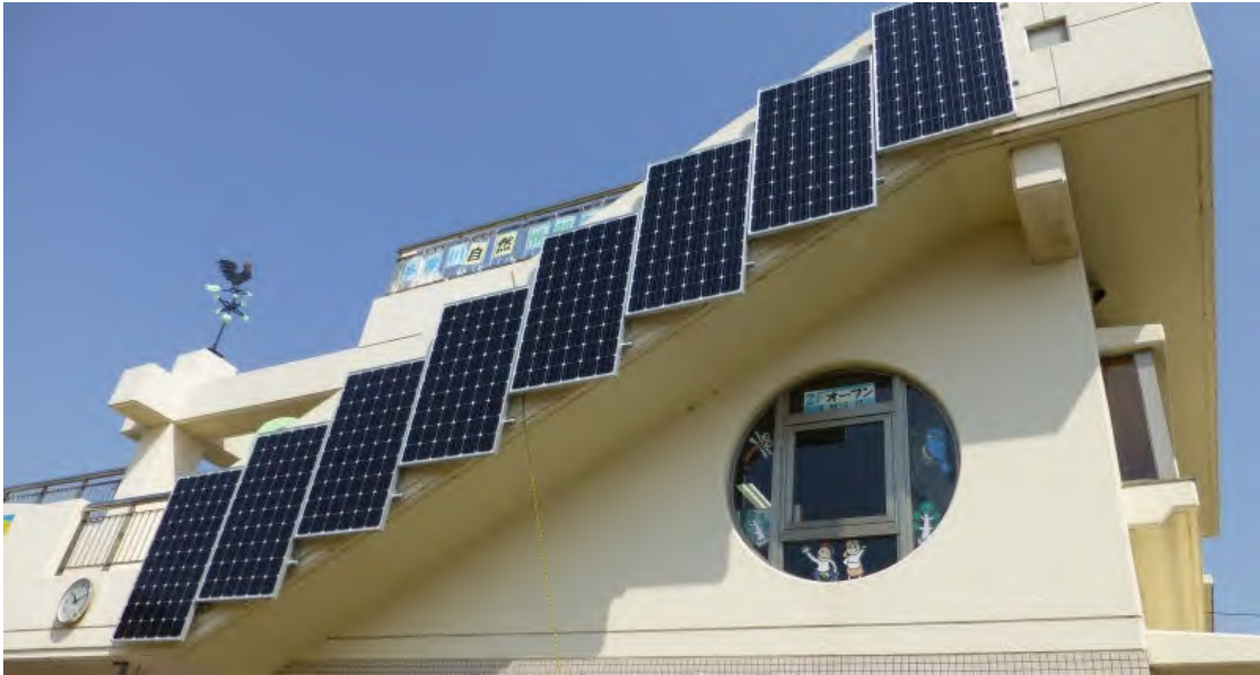
多摩川自然情報館の太陽光発電パネル
