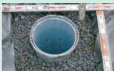
■宅地への雨水浸透ますの設置
