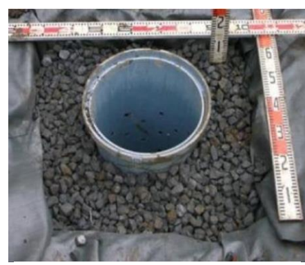
宅地内 雨水浸透ます
