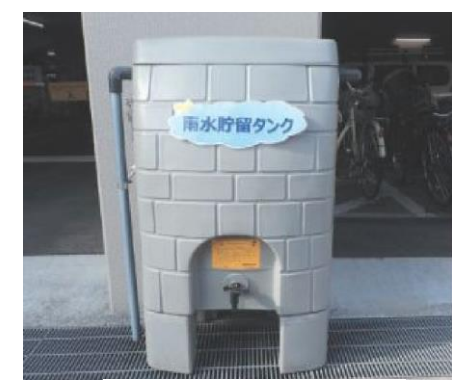
雨水貯留タンク
