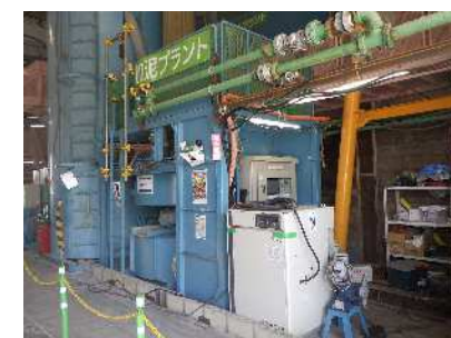
鉍物系添加材用泥水タンク
